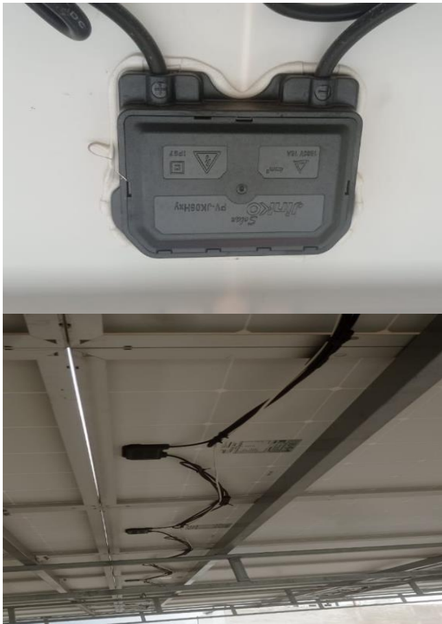
Figura 10. Instalación de los paneles: a) Caja de conexión y b) Conexión en serie. Fuente: elaboración propia.
