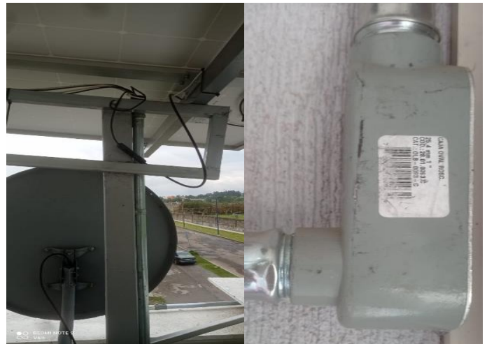
Figura 11. Conexiones: a) Bajada de cables y b) Caja oval ROCS. Fuente: elaboración propia.
